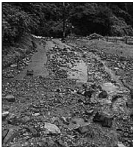
林道上浄法寺線 土砂流入
