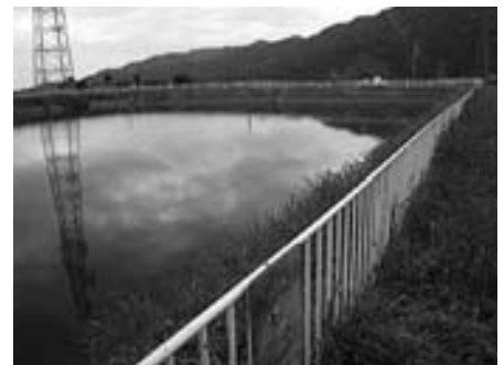
漏水調査・花谷ため池
