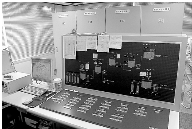
上水道中央監視操作盤
